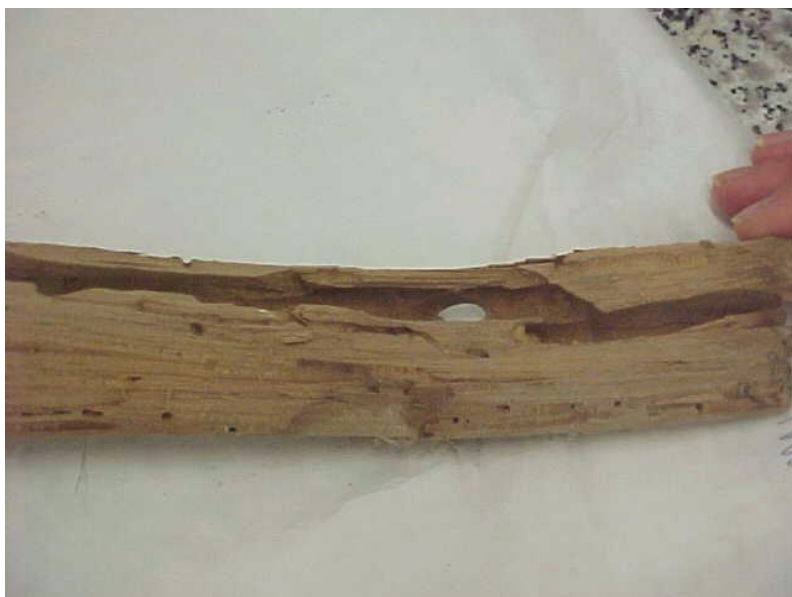
Fig. 1 – Madera anclaje: galerías de sección superior a 6mm: Cerambícidos
