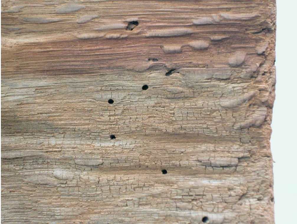
Fig.3- Zona con pudrición parda (madera fracturada en forma de cubos).
