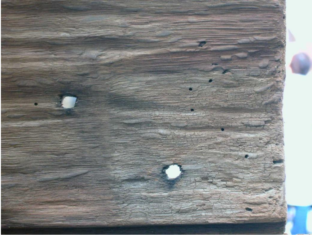
Fig.1- Orificios de salida de anóbidos y zona con pudrición (madera fracturada en forma de cubos).
