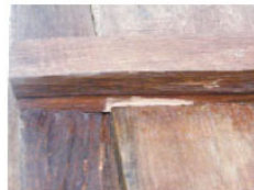
LENGÜETAS DE MADERA EN LOS TRAVESAÑOS QUE SUPLEN LA PÉRDIDA DE LA MISMA
