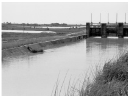
Estado actual del canal y compuerta de regulación. Foto: Lolo Velasco
