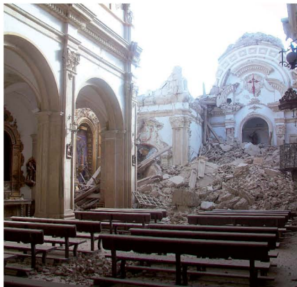
Estado de la iglesia de Santiago tras el terremoto sucedido en Lorca (Murcia). Foto: Antonio Periago
