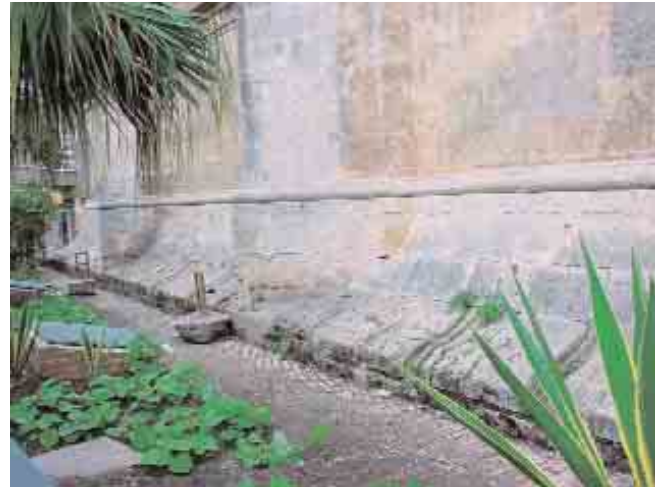
⑤ Revestimientos recubriendo las zonas bajas de los muros afectados por la humedad / MARTA GARCÍA DE CASASOLA, IAPH
