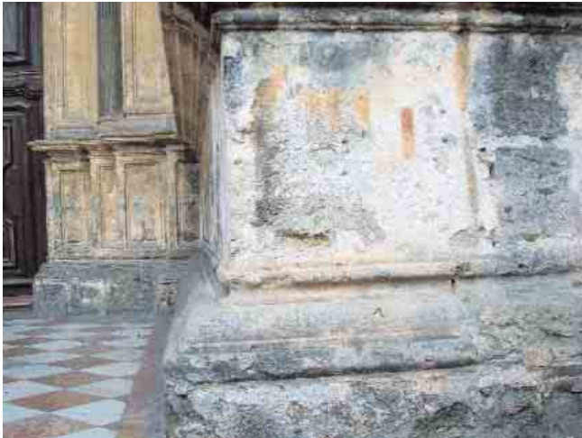
📍 Zona con importantes pérdidas de revestimientos / MARTA GARCÍA DE CASASOLA, IAPH
