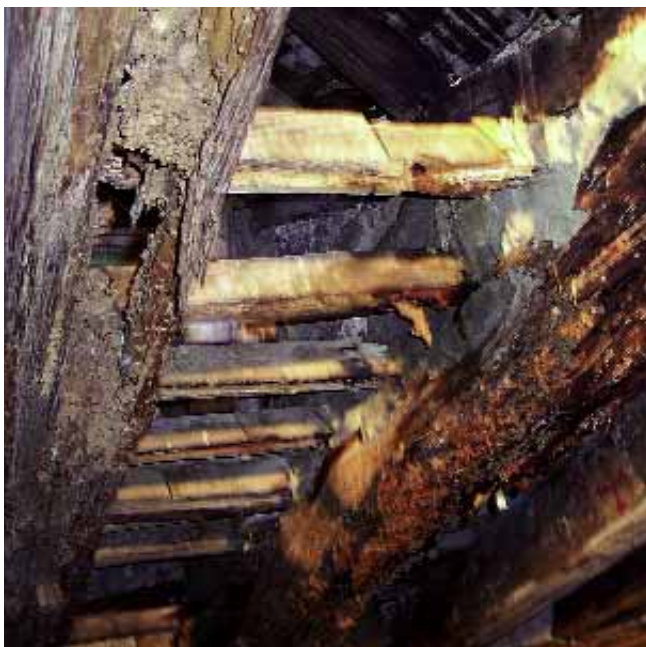
⌚ Estado previo de la vigería de rollizos y escuadrías policromadas por ataque de termitas / FOTO: VALENTÍN TRILLO
