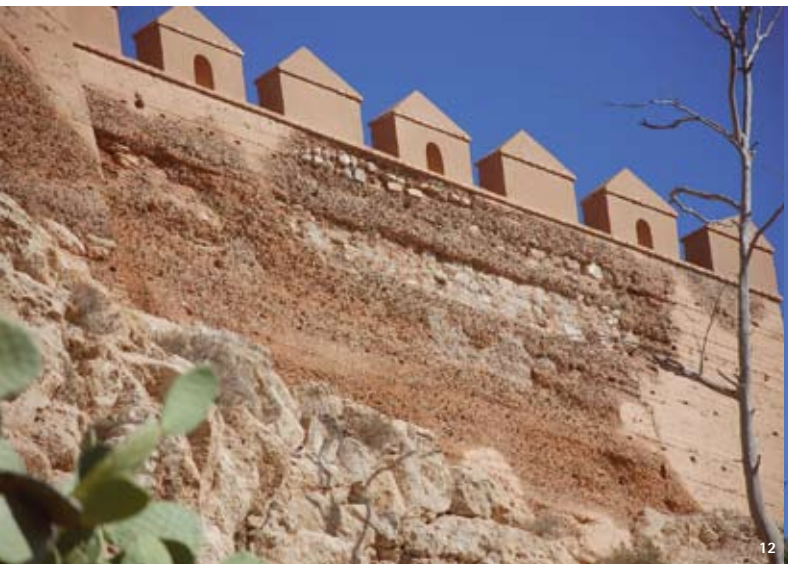
12. Detalle de deterioros en la muralla sur del Conjunto Monumental de la Alcazaba. Tramo restaurado en los años 80. Foto: María Luisa García Ortega
