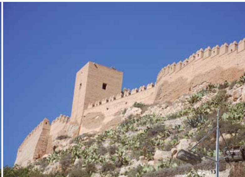
13. Muralla sur del Conjunto Monumental de la Alcazaba. Tramo restaurado en los años 80, del primer y segundo recinto. Deterioros y manchas de humedad. Foto: María Luisa García Ortega
