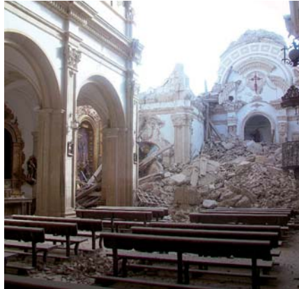
Estado de la iglesia de Santiago tras el terremoto sucedido en Lorca (Murcia). Foto: Antonio Períago
