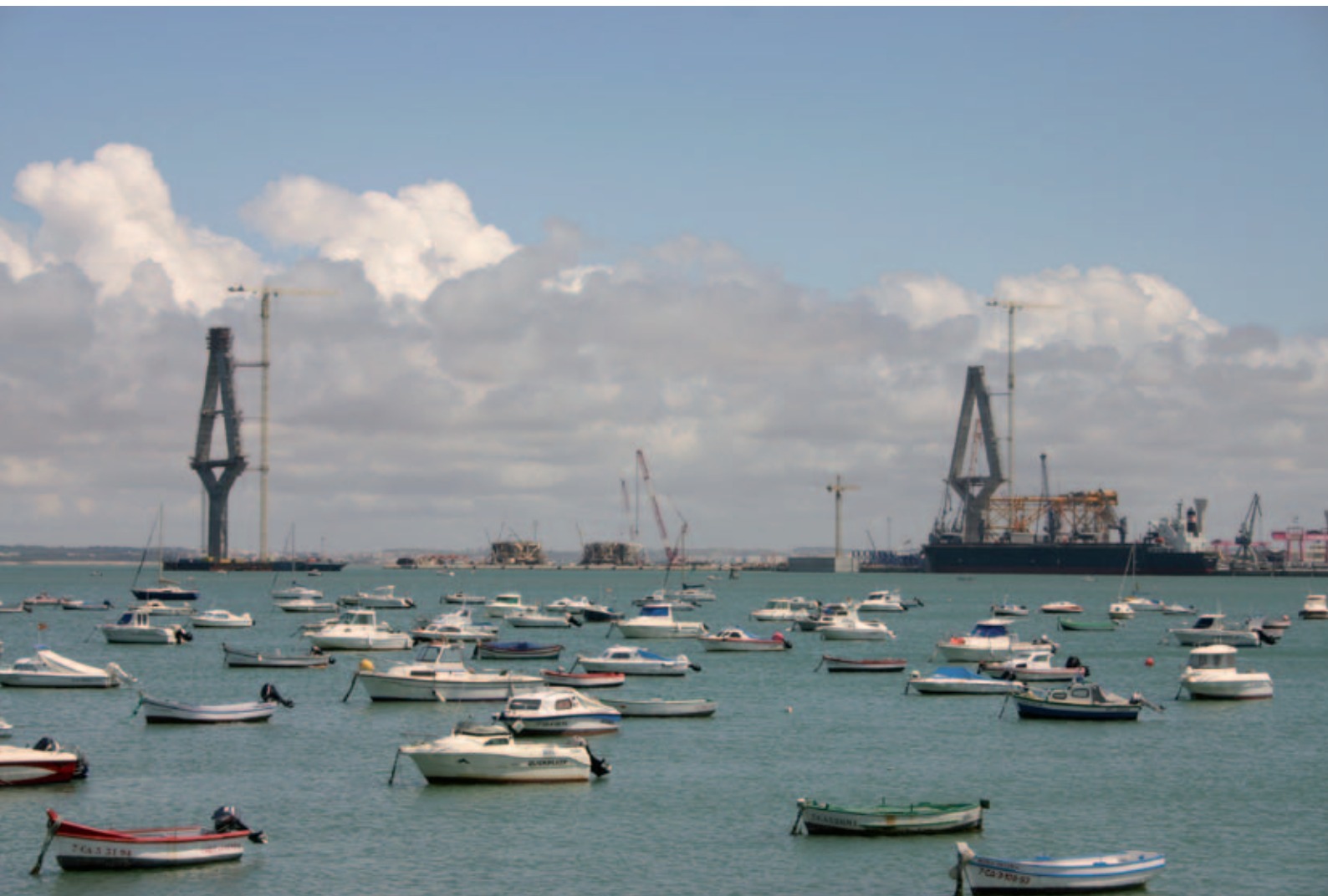
Puente de La Pepa, "segundo puente", actualmente en construcción, que cruzará la Bahía de Cádiz. Foto: José Ramón Barros Caneda, autor de todas las imágenes que ilustran este artículo, salvo que se especifique lo contrario
