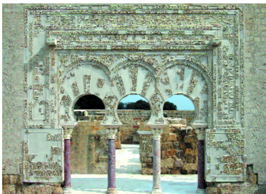
Portada de la Casa de Ya'far, antes y después de la intervención
