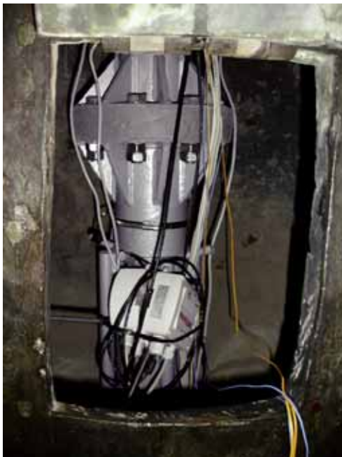
④ Cableado e instalación de sonda de temperatura y humedad en el interior de la Tinaja / FUENTE: GRUPO DE ESTRUCTURAS, UNIVERSIDAD DE SEVILLA
