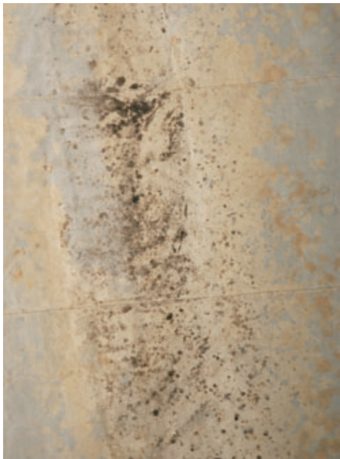
12. Debilidad y pérdida de consistencia física en zonas afectadas por humedad y microorganismos. Detalle del anverso, zona central izquierda. Foto: Eugenio Fernández Ruiz, IAPH
