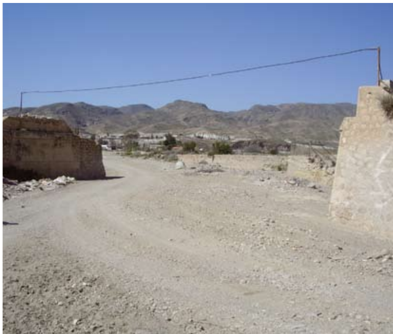
Puente de la rambla Carrillo. La pilastra de apoyo intermedio ha desaparecido. Fuente: Fondo ASAFAL
