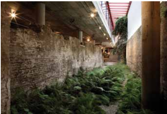
Barbacana. Estado previo
