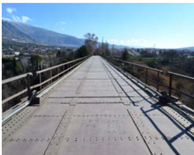
Vista del tablero
