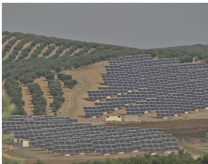
Placas solares | foto Miradas de Andalucía
