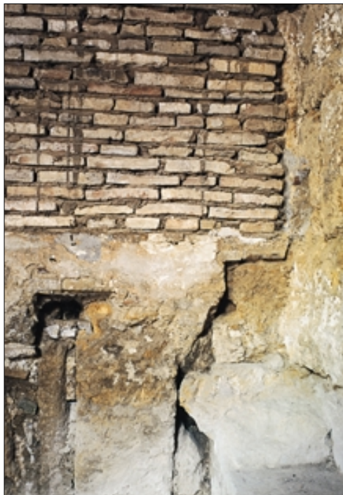
Pedestal del podio romano flanqueando el pasaje Norte y conducción de drenaje delante del mismo.
