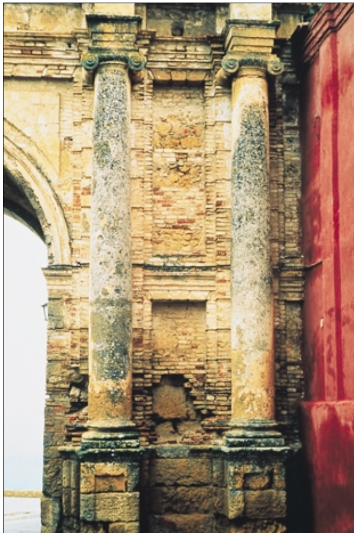
1. Vista de la fachada oeste, lateral derecho, en las que se pueden observar las distintas patologías que afectan a la piedra alcoriza, fábrica de ladrillo y revestimientos.
