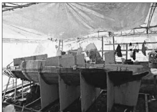
6. Fase final de la excavación; construcción del doble molde y de la estructura de sujeción.
