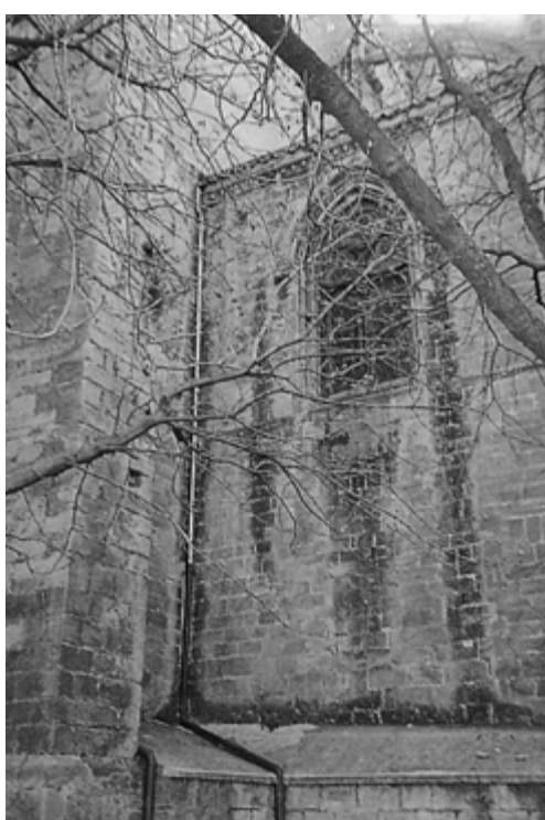
3. Nave lateral Norte del Templo de la Catedral de Pamplona. Las zonas de mayor humedad y menor insolación se prestan al desarrollo intenso de musgos y algas que pueden dar lugar, como en la fotografía, a depósitos superficiales y películas biológicas, respectivamente.
