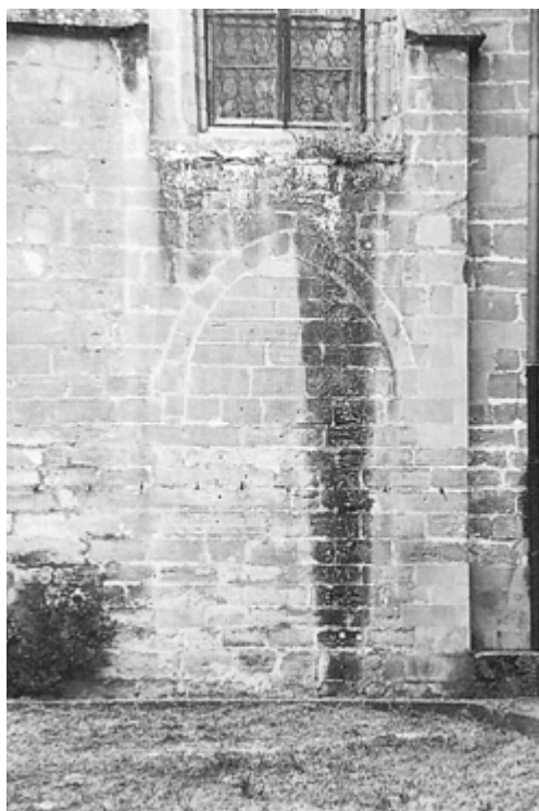
1. Nave lateral Sur del Templo de la Catedral de Pamplona. Las humedades provocadas por el mal estado de algunas estructuras, el desarrollo de plantas superiores... favorecen el crecimiento de numerosos organismos vivos (algas, líquenes, bacterias,...)
