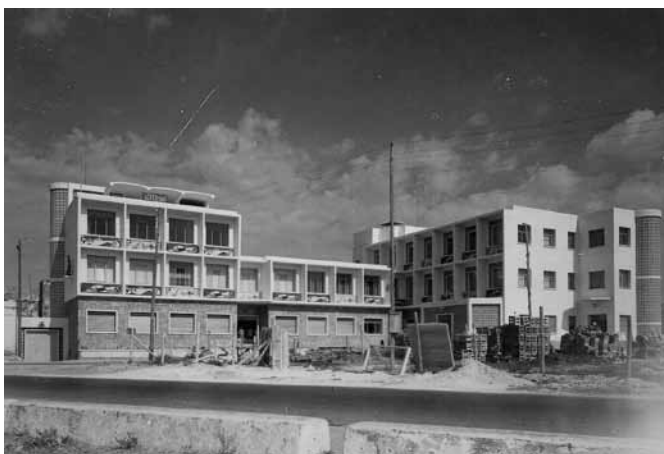
Ambulatorio Hermanos Laulhé en obras. Fuente: Archivo Joaquín Quijano Párraga (San Fernando, Cádiz)
