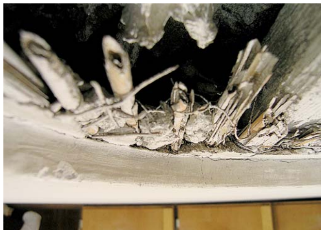
Dormitorio de Fritz Tugendhat, agujero en techo por eliminación de la lámpara. La estera de cañas es utilizada como un soporte tradicional para la estructura del techo enlucido y se queda suspendida con el apoyo de una malla de alambre. Foto: HAWK/Hammer
