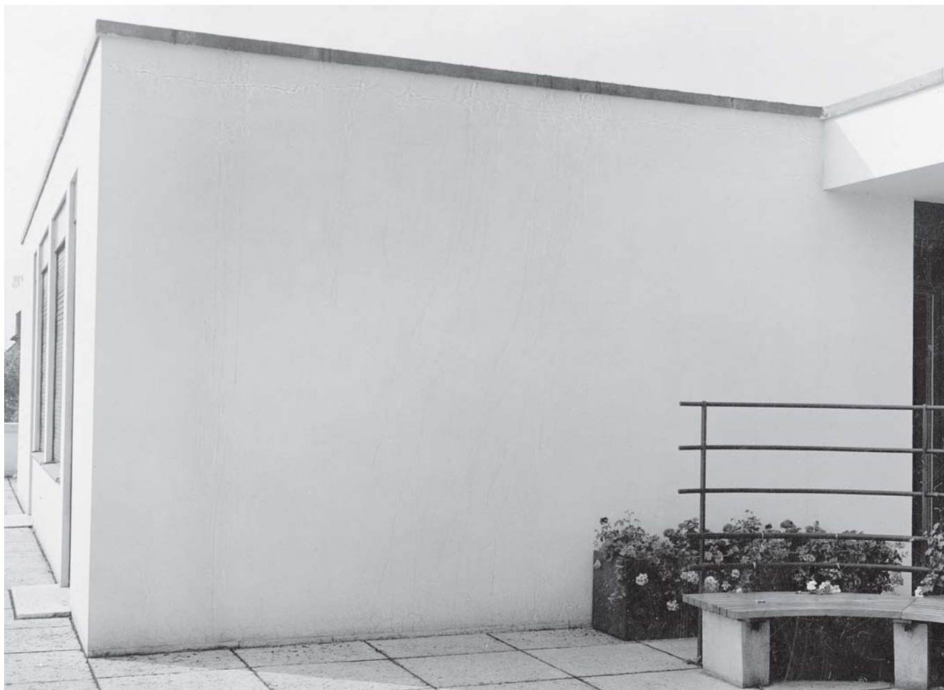
En la fachada este del dormitorio de Grete Tugendhat, poco después de la terminación de la obra, aparecieron grietas entre la estructura del techo de hormigón y la pared de ladrillo causadas por los diferentes coeficientes de dilatación de los materiales. Foto: Sandalo, 1931
