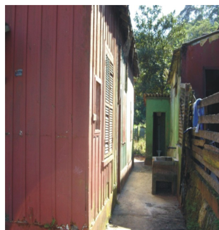
Eliminación de los anexos irregulares o en malas condiciones | fuente Prefeitura Municipal de Santo André, 2007
