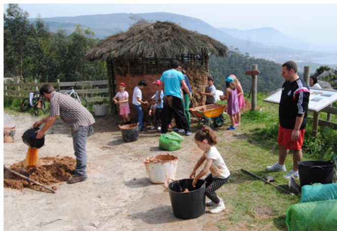
Taller de construcción de cabaña castrexa junto al yacimiento A Cabeceña, gestionado por el vecindario de la zona y el proyecto Costa dos Castros | Asociación Costa dos Castros
