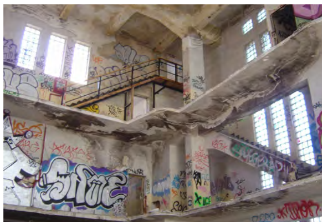
Estructura de acceso a los pisos de las galerías de la cárcel, noviembre 2007 | fotos Víctor Fernández
