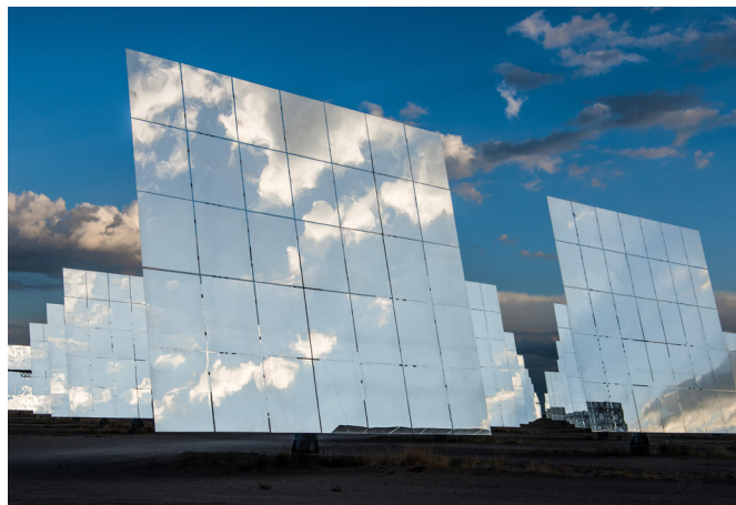
Instalación termosolar Crescent Dunes, Nevada, Estados Unidos (2017) | foto National Renewable Energy Lab (Dennis Schroeder)
