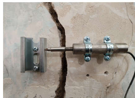
Transductor de desplazamiento con una precisión de 1 micra instalado en una fisura estructural en la fachada de la iglesia parroquial de Constantí. Se encuentra conectado a un cuadro de maniobras y data logger del sistema de monitorización, que consta de 4 fisurómetros como el de la figura y dos PT100 de lectura de la temperatura interior y exterior | foto Fempatrimoni 2.0
