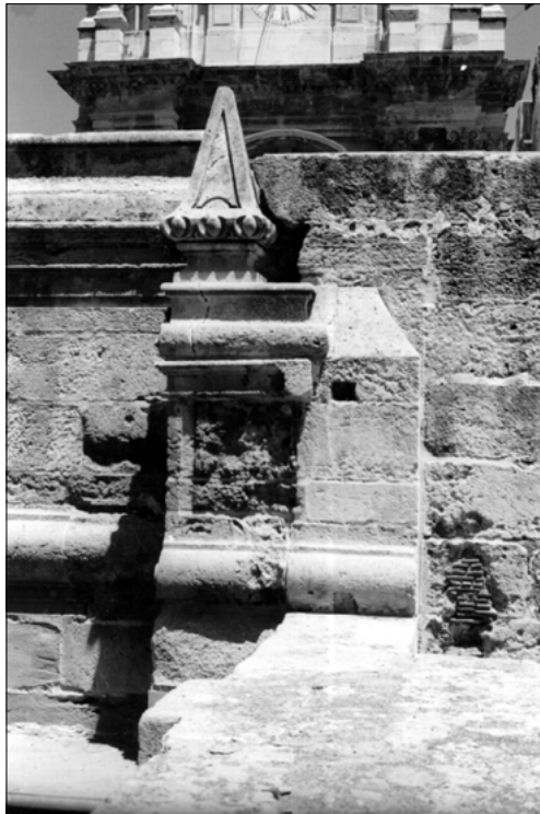
9. Pérdidas de material en remates y rellenos de ladrillo en zonas Sur de la coronación de la fachada principal.
