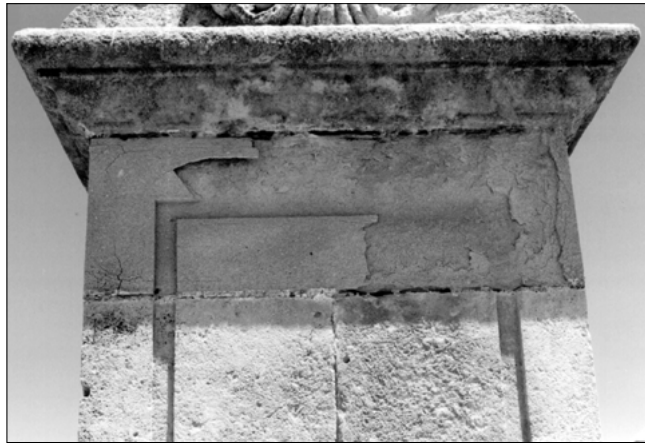
10. Descamaciones en los pedestales de la nave Sur.
